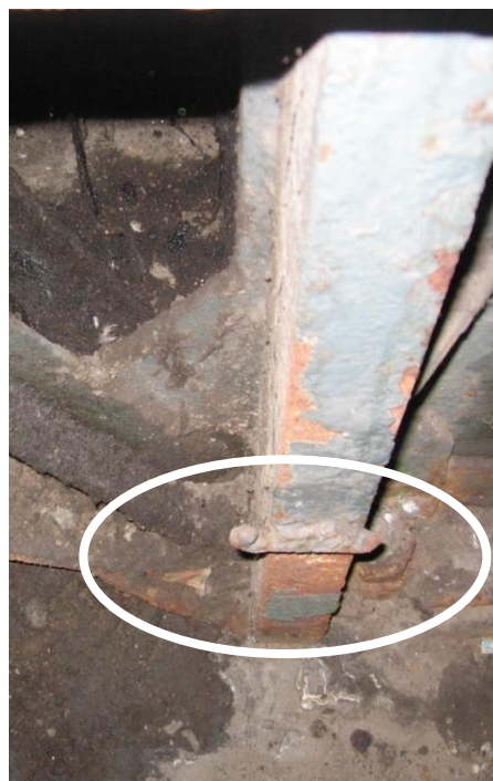
Рис. 2. Коррозия узла соединения горизонтальной и наклонной зон в зоне А
