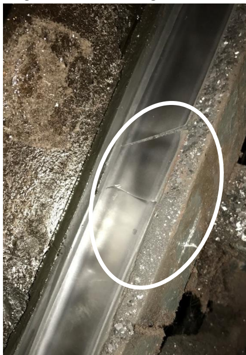
Рис.1. Трещина направляющей бегунка ступени
